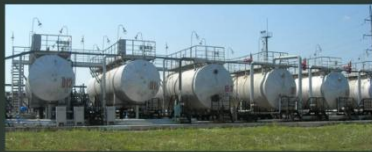
Установка комплексной подготовки нефти (УКПН)
