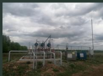
ГЗУ-Групповая замерная установка
