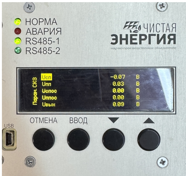
Рисунок 1 – Экран станции катодной защиты (СКЗ)
