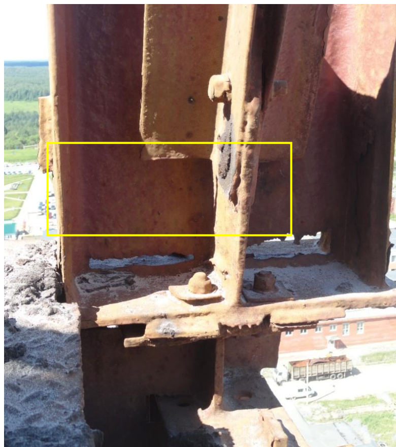
Рис. 3 – Сквозная коррозия стенки стойки копра
