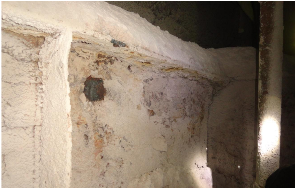
Рис. 2 – Разрушение антикоррозионного покрытия по всей поверхности элементов балок опорной рамы. Отложение соли на поверхности конструкций высотой до 150 мм.
