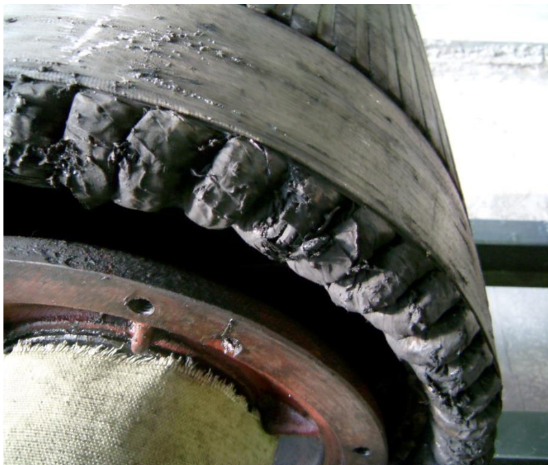
Рис. 2. Фотография повреждения лобовой части
