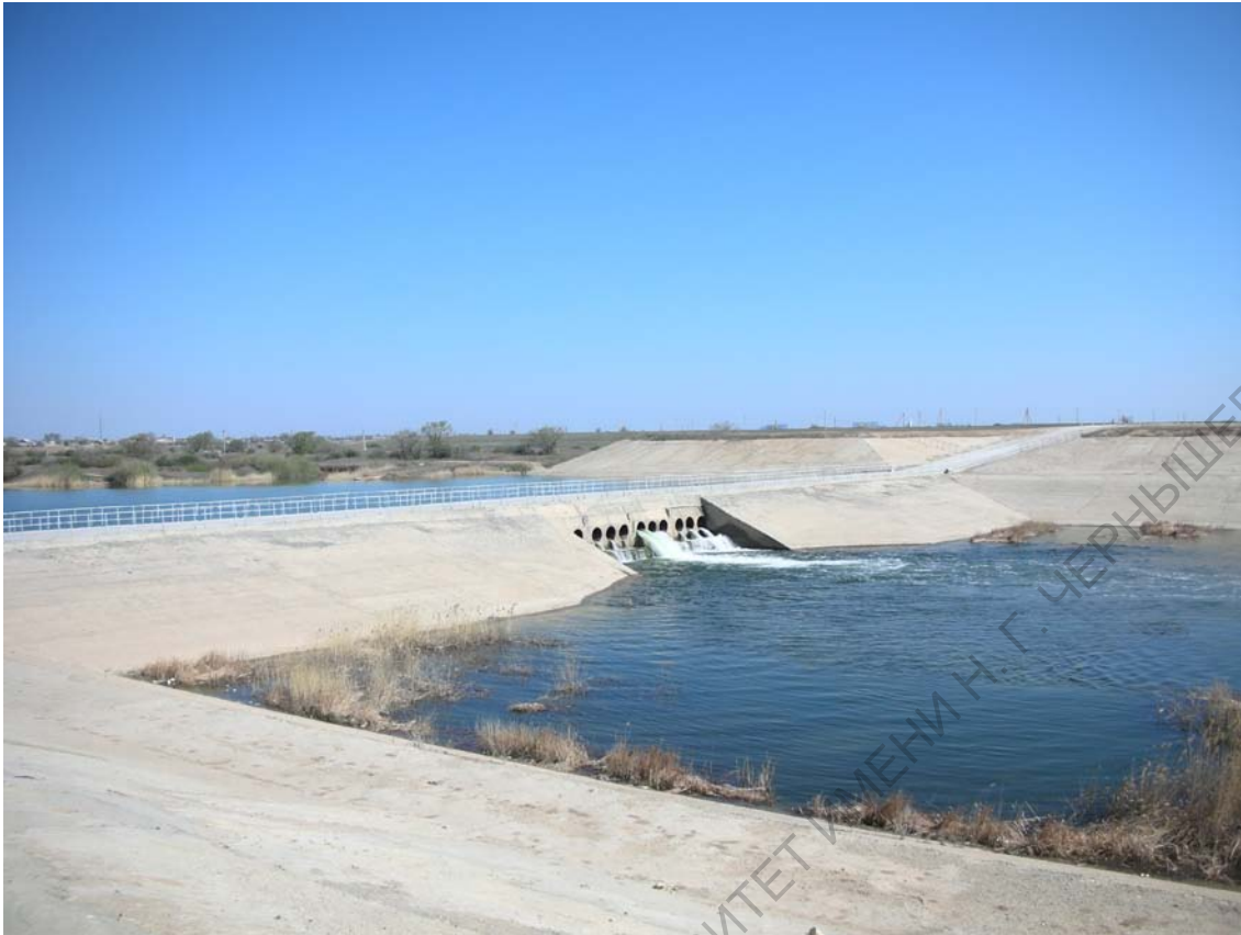
Рис. 2.3. Плотина на реке Большой Узень в 1,3 км к юго-востоку от с. Новоалександровка. Фото Н. В. Пичугиной (2010 г.).
